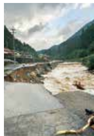
道路の陥没で寸断された道
